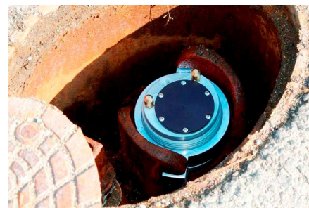
Sebalog P umístěný v hydrantové šachtě
